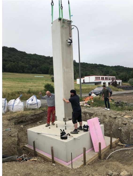
Abbildung 6: Montage der Energiesäule mit den vorgefertigten Elementen für das Fundament und den Turm
